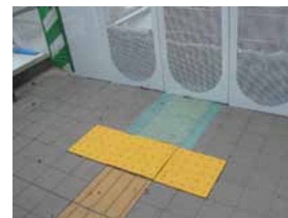
工事中には、貼付式の点状（警告）ブロックを暫定的に敷設
