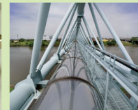
大きな地盤変動に耐える溶接接合鋼管 を使用した高圧ガス導管
